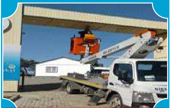
Niksar Camping Giriş Kapısı Aydınlatma
