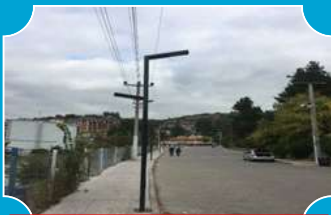
Ayvaz Parkı Ön Cephe Yolu Aydınlatması
